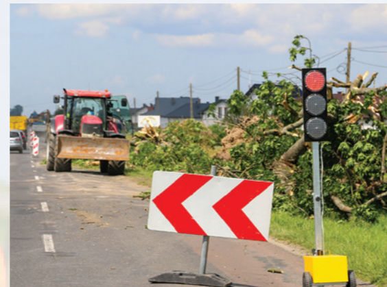
Droga z Lubaczowa do Baszni Dolnej zostanie poszerzona do sześciu metrów, a wzdłuż niej powstaną chodniki i ścieżki rowerowe.
